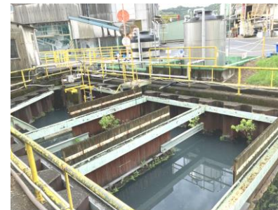
排水中和設備
