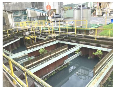
排水中和設備
